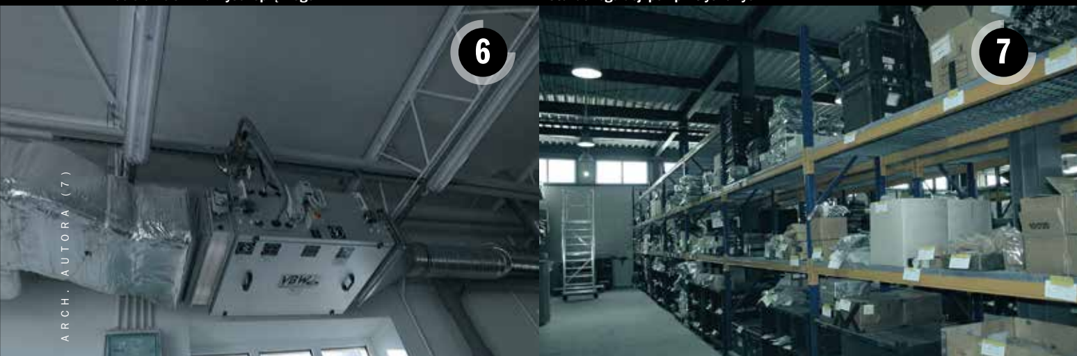
Część instalacji wentylacyjnej
