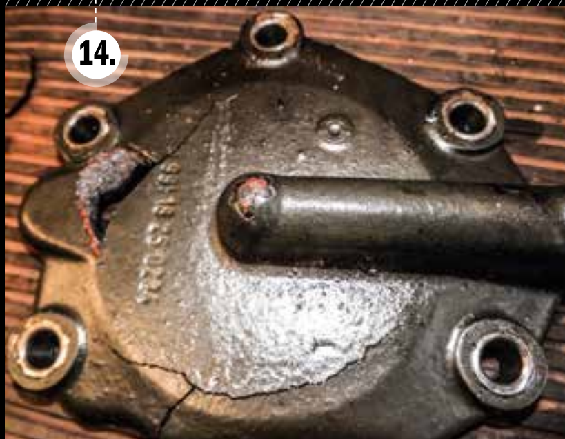
Uszkodzona pokrywa uszczelniająca
